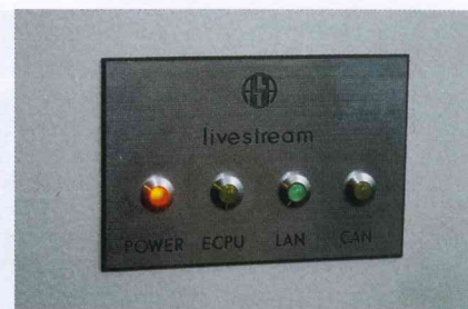
Die Funktion des ASA-Livestreams wird am Schaltschrank des Prüfstandes angezeigt
