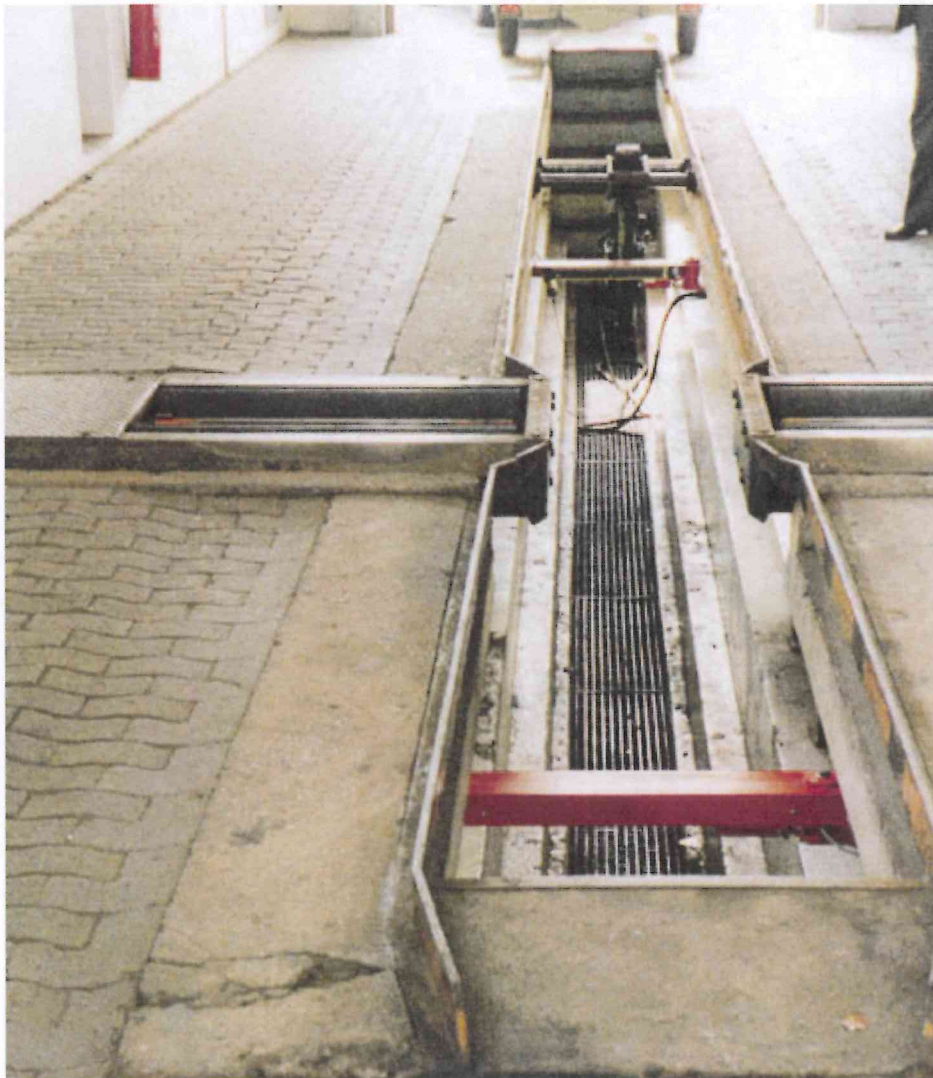
Bild 14-2: Sicherung des Gefahrenbereiches in der Arbeitsgrube durch klappbare elektrooptische Einrichtung (an dem über die Fahrbahn hinausragenden Rollensatz fehlt der Warnanstrich)
